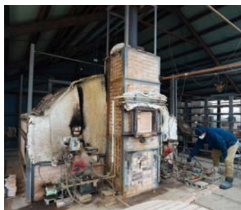
無事だった幅4メートルの窯。販路拡大を見据え、新商品開発のために導入していた。
